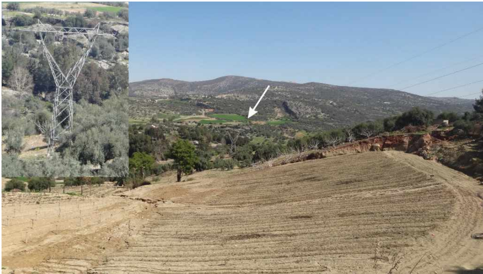
Şekil 2. Çalışma konusunu oluşturan elektrik direğinin genel görünümü.
